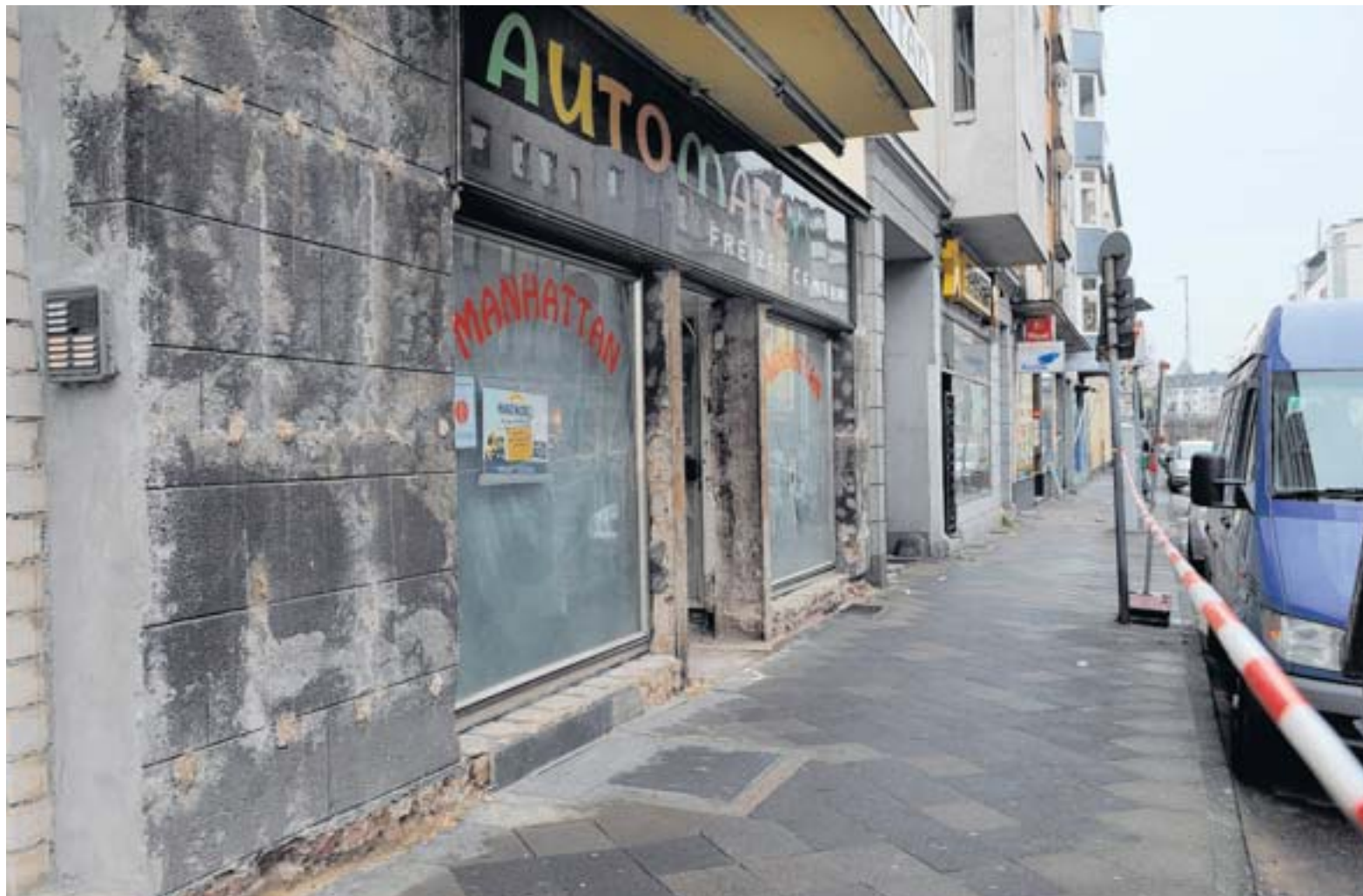
Schmutzdecken – wie hier an der Ecke Mintropstraße/Stresemannplatz – sind in der südöstlichen Innenstadt keine Seltenheit.
